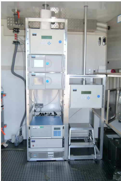
Abbildung 7: Innenausstattung der mobilen Luftgütemesstation
